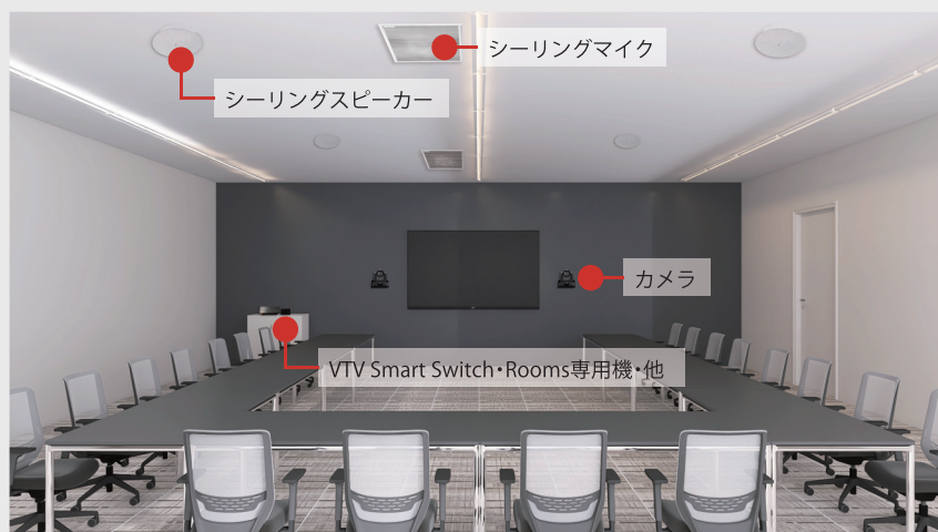
マイクやスピーカーは天井、カメラは壁面取り付けでケーブルレスな会議室に
